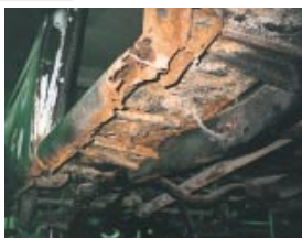
床面の腐食はひどい状態(車両の下から)
